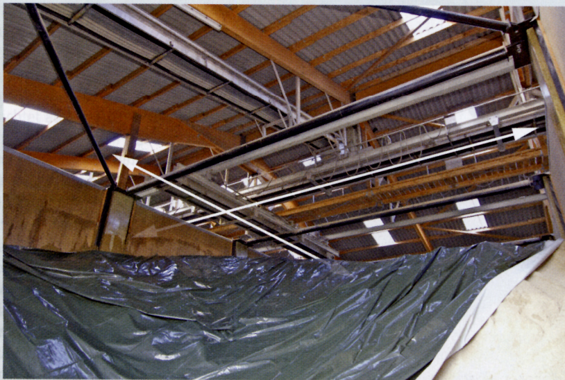
Mittels zweier verfahrbarer Förderer lässt sich jeder Punkt in der Lagerhalle erreichen.
