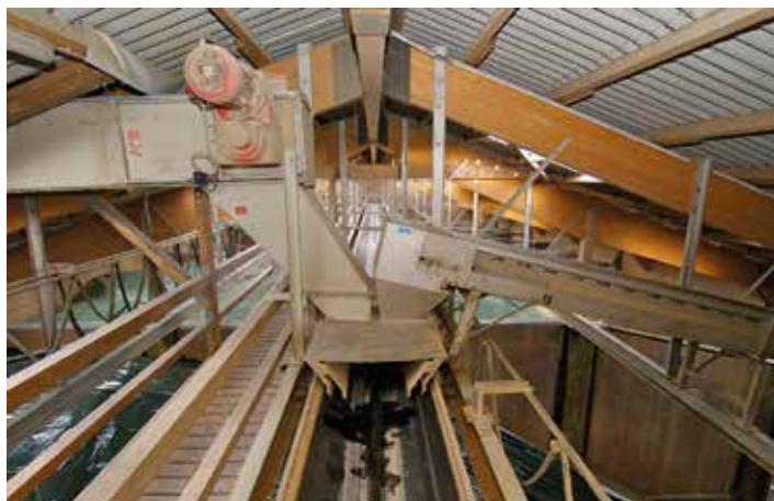
Abb. 2: Der zuführende Getreideförderer (re.) wurde hier seitlich unterhalb des Hallendaches eingebracht. In der Mitte ist deutlich das lange Hauptverteilband zu erkennen, das längs der Firstflucht montiert ist. Links ist eine Absaugvorrichtung zu sehen.
